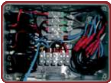
Вологозахисна коробка електричних з'єднань
