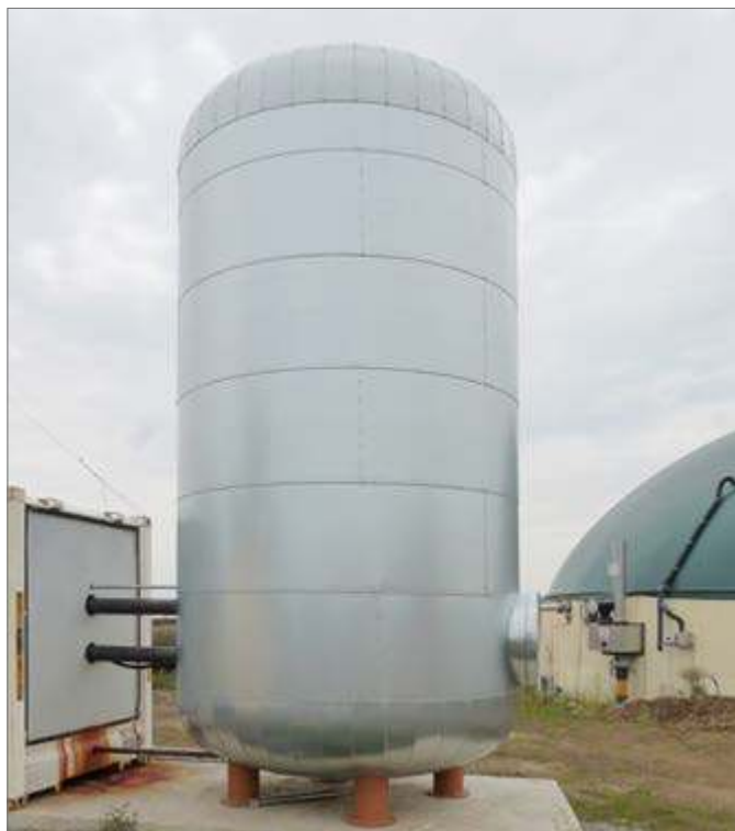
Рис. 6-8 Центральный аккумулятор тепла
