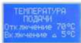
Рис. 11 – Настройка температуры подачи теплоносителя
