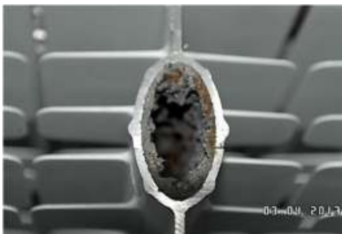
- Последствия коррозии алюминиевых радиаторов;
