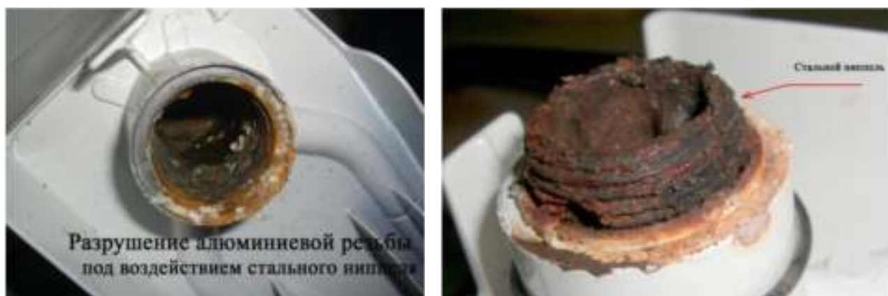
Рисунок 3. Последствия коррозии ниппеля
